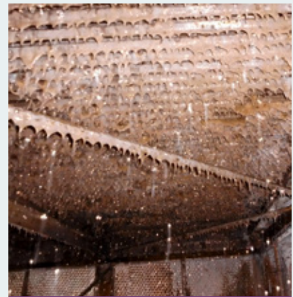
Massiver Biofilm auf Rohrbündel der VKA
