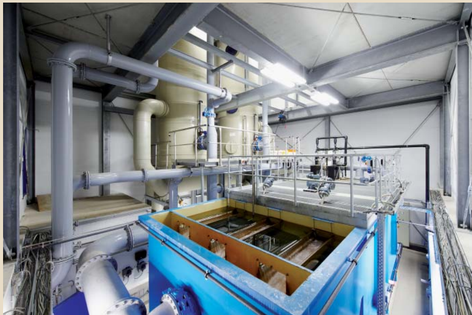
Abb. 2 Trinkwasseraufbereitung bei den Stadtwerken Iserlohn: Das System ist für bis zu 480 m³/h ausgelegt mit einem nominalen Durchsatz von 320 m³/h
