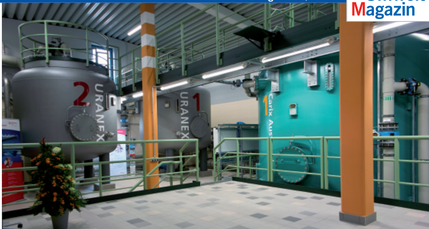
In Windesheim wurde die bisher größte Uranex-Anlage und eine der größten Carix-Anlagen gebaut. In beiden Fällen handelt es sich um Ionenaustauschverfahren.
