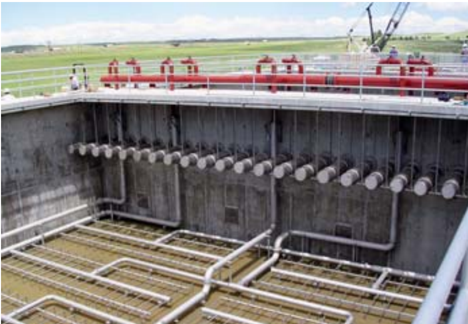
Bild 2: Mechanische Ausrüstung des Schwebebett Reaktors
