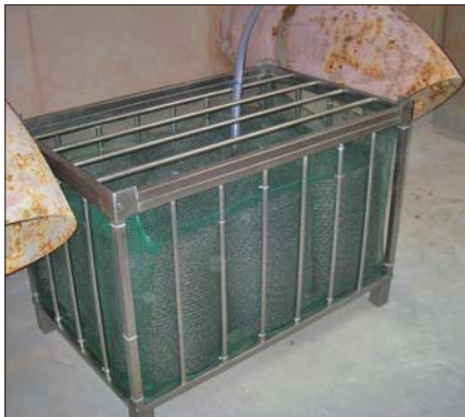
VWS MOL CLEAN-Katalysatorbox in der Kühlturmtasse eines Verdunstungskühlkreislaufer (Durchsatz circa 2000 m 3 /h)
