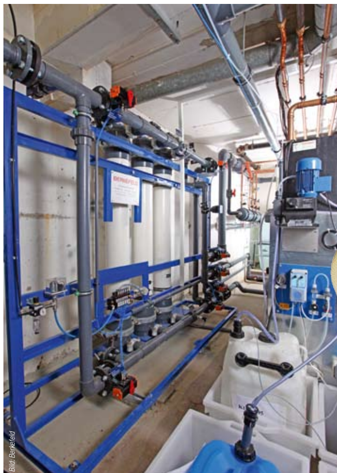
Bild 2 Die UFlex Ultrafiltration mit einer Aufbereitungsleistung von 24\ \text{m}^3/\text{h} (links) und die Dosierstation.
