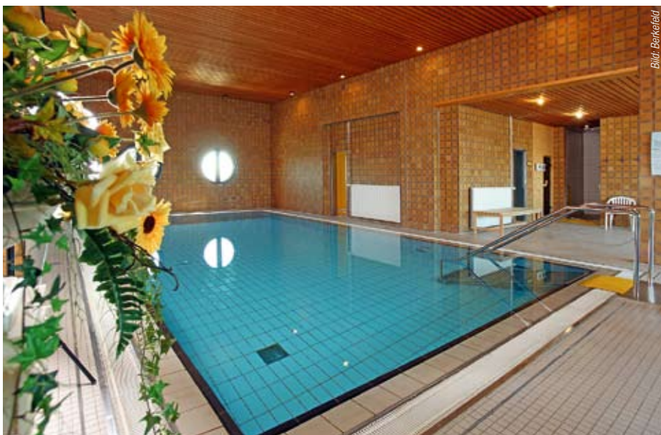
Bild 5 Typisches Hausschwimmbad der 1970er-Jahre mit typischem Problem: Hohe Betriebskosten. Die modernisierte Wassertechnik mit einer Ultrafiltration reduziert die Betriebskosten und verbessert zudem die Hygiene.
